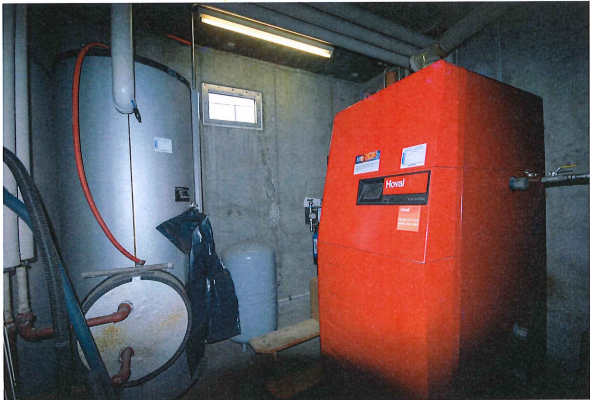
Local chauffage commun au sous-sol avec chaudière à gaz et boiler
