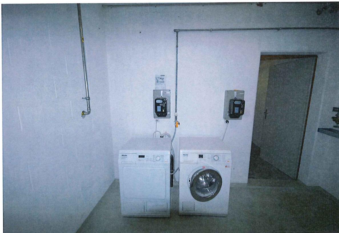
Buanderie commune au sous-sol
