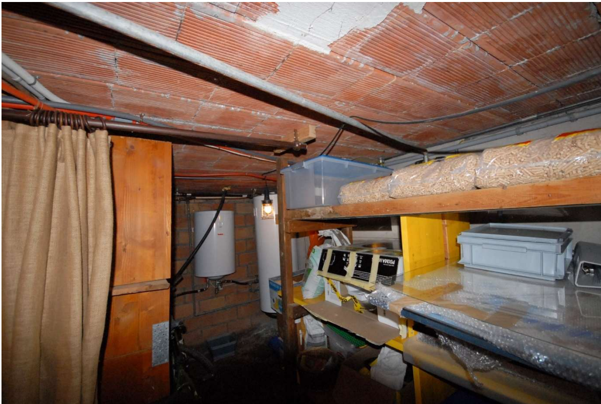
Cave au sous-sol avec boiler
