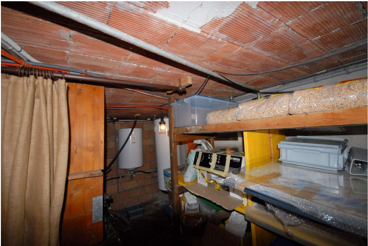
Cave au sous-sol avec boiler
