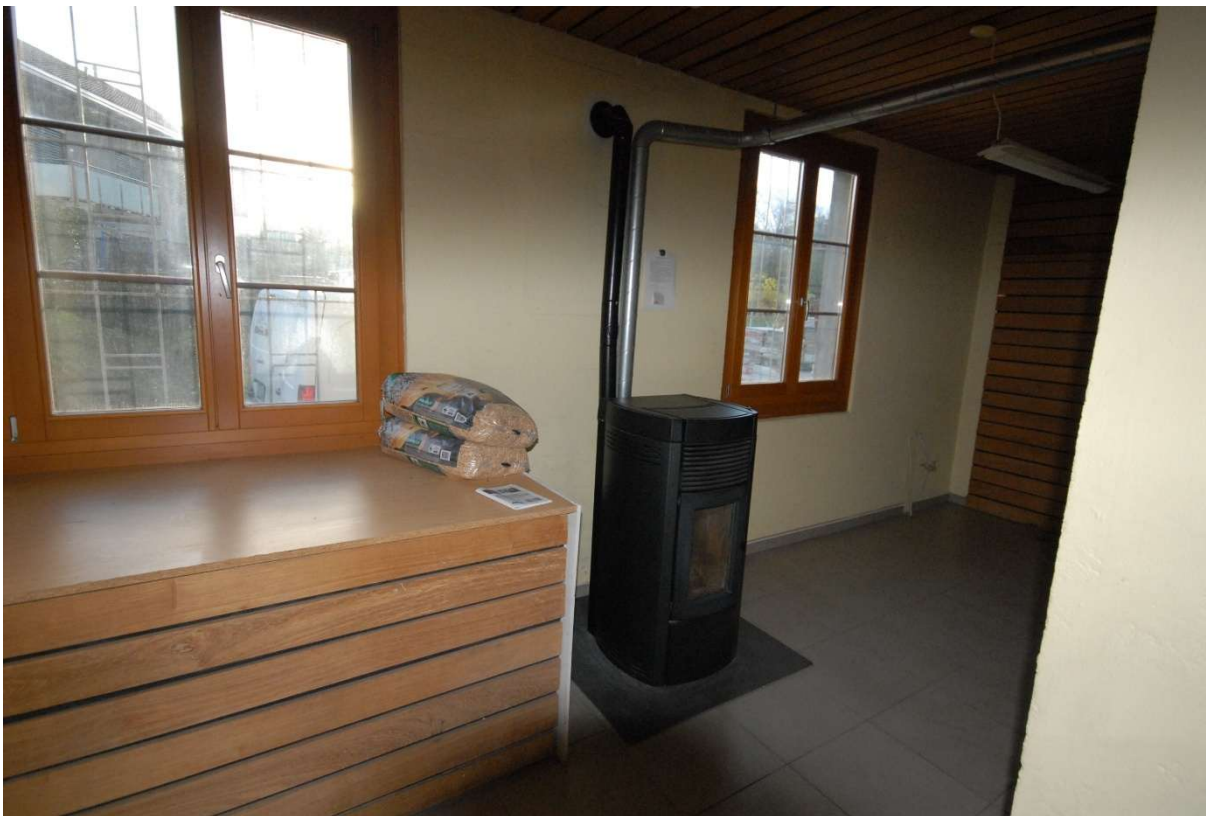
Poêle à Pellet dans l'espace bureau
