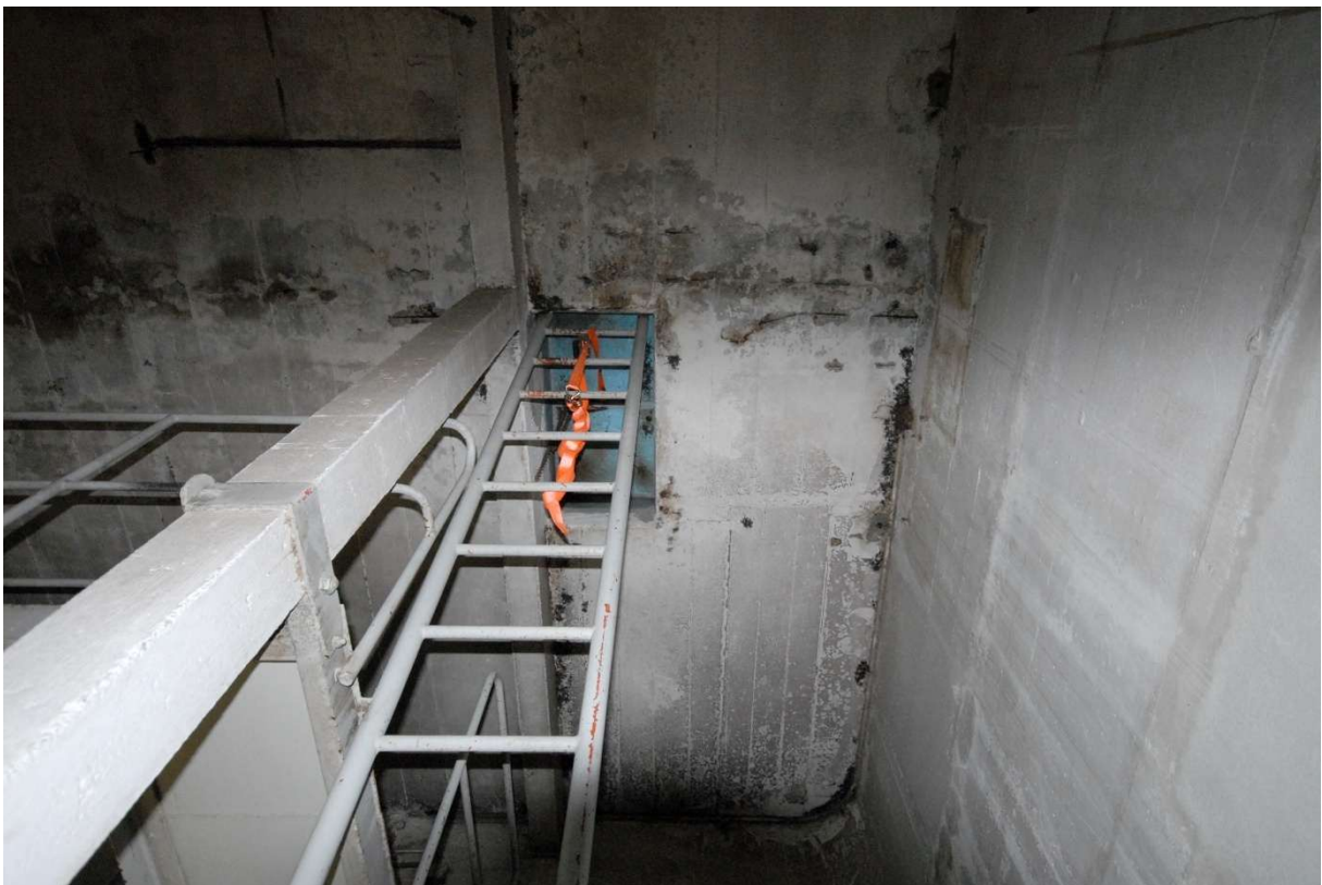
Local d'installation technique en haut des silos désaffecté avec dalle de la toiture détériorée
