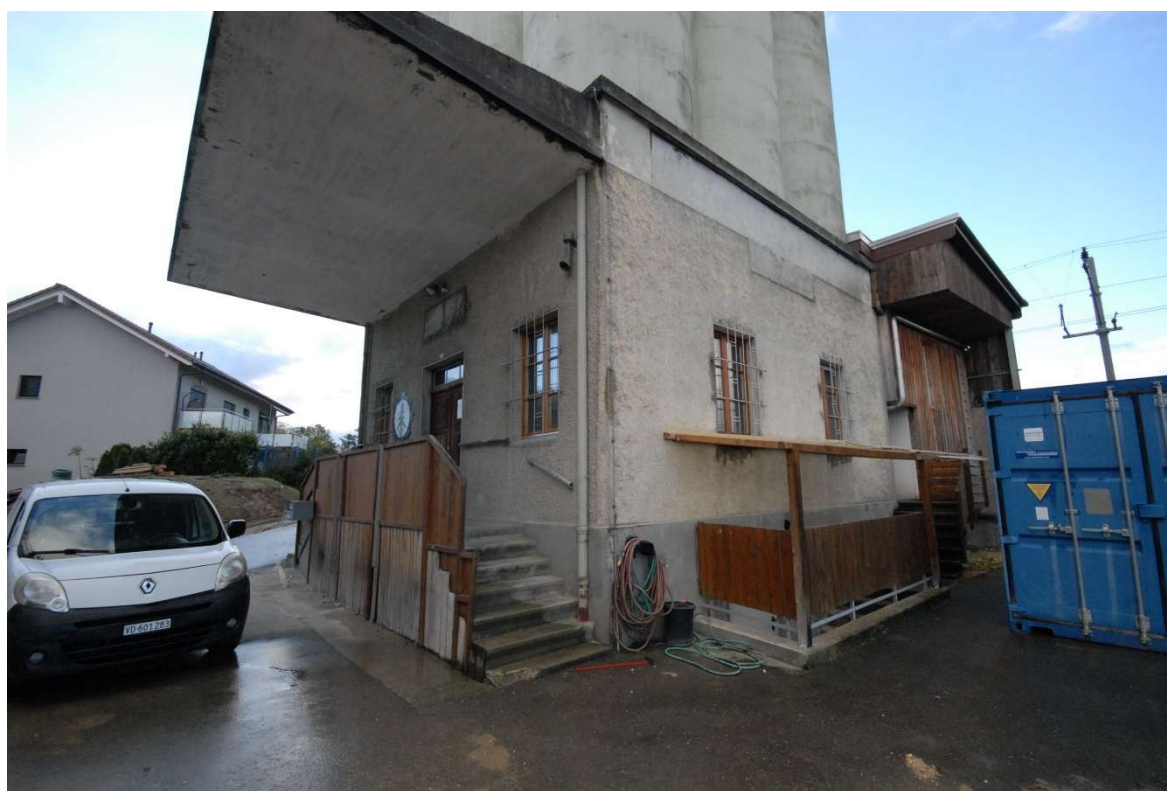
Vue des bureaux extérieur, avec escalier extérieur pour accéder au sous-sol accessible également depuis un escalier intérieur. Sur la droite de l'escalier, accès à l'escalier du silo
