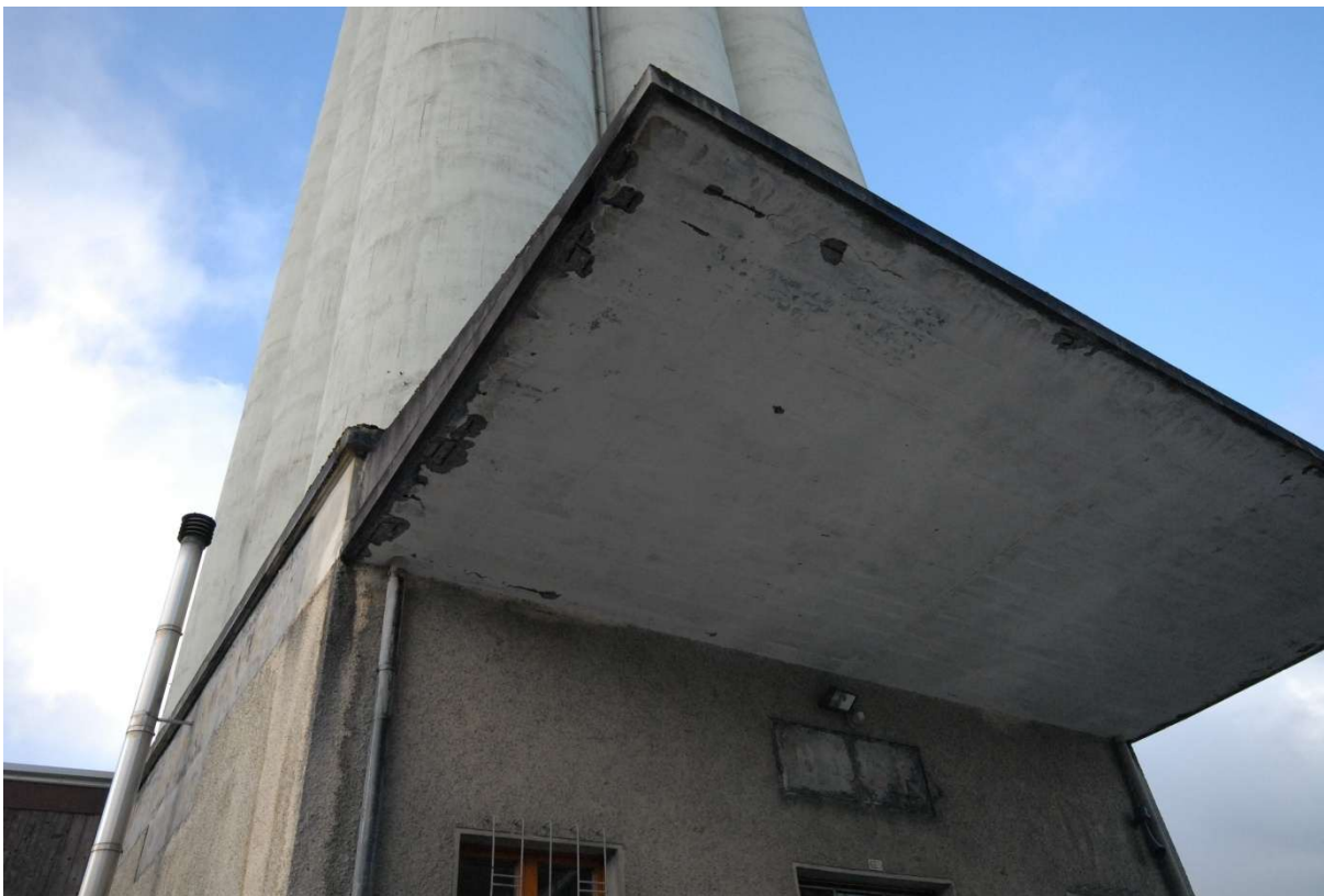
Auvent de l'entrée du bureau détérioré
